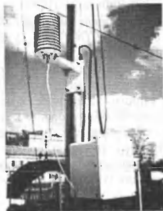
Рис. 4.3. Вид станции МР-16
